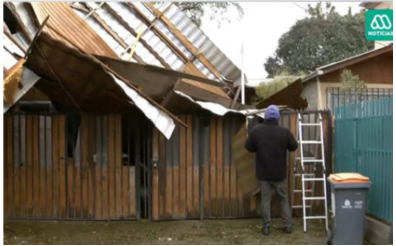
Cayó techumbre en calle O'Higgins
